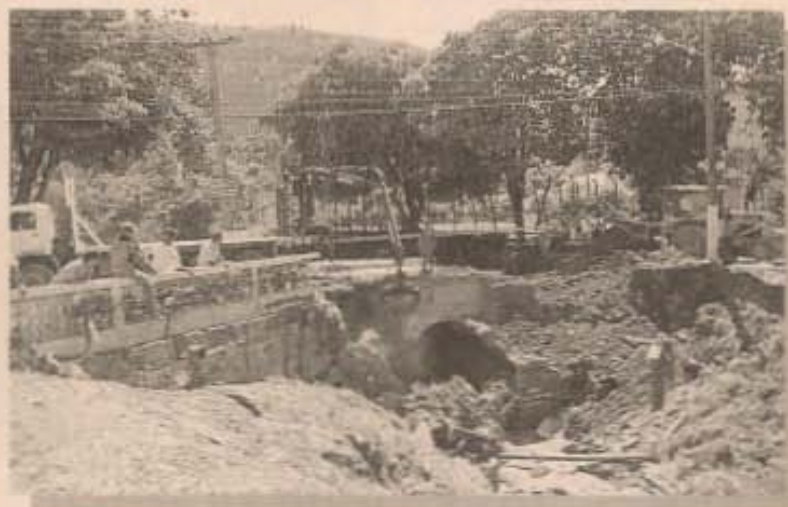
O pontilhão do Rosário, sendo desentupido pela Defesa Civil.
